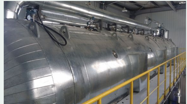
大型低温多效海水淡化中试工程
