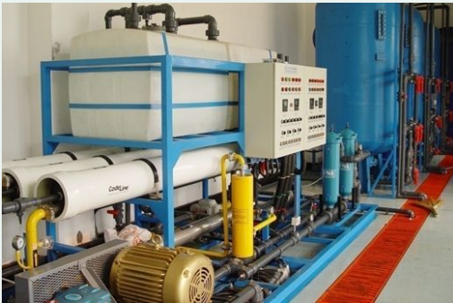
高抗污染型反渗透海水淡化工程
