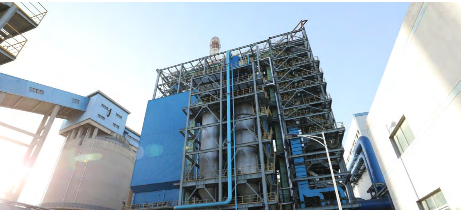
脱硫脱硝一体化工程
